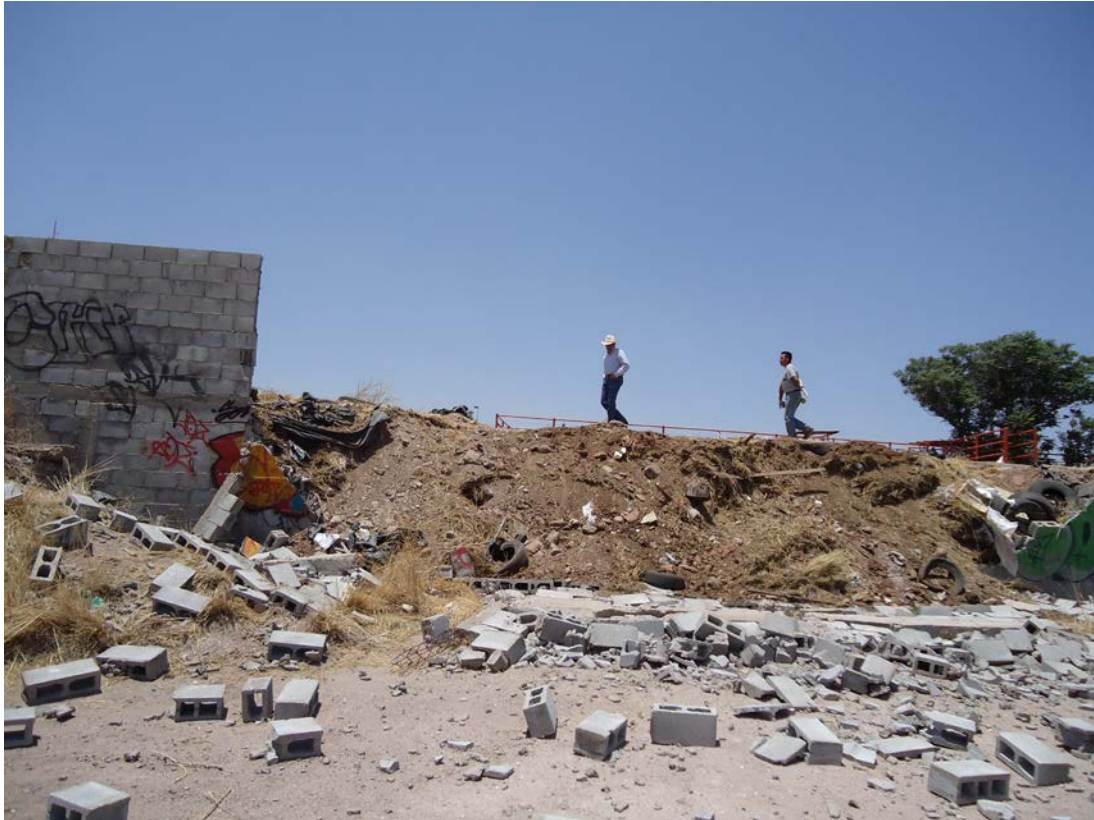
Vista exterior del daño del muro
