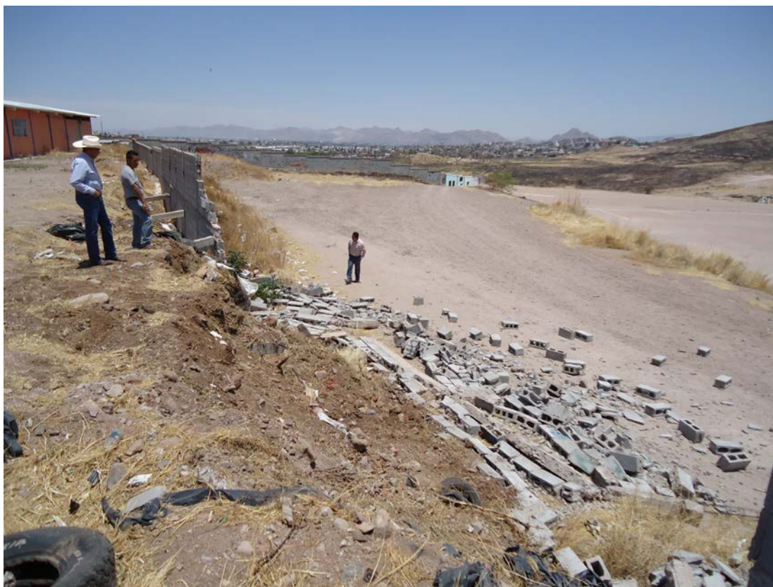
Vista lateral del daño del muro de Block
