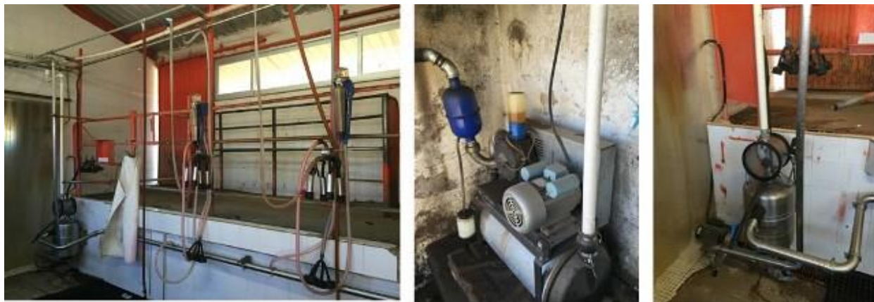
Imágenes del equipamiento de sala ordeña.
