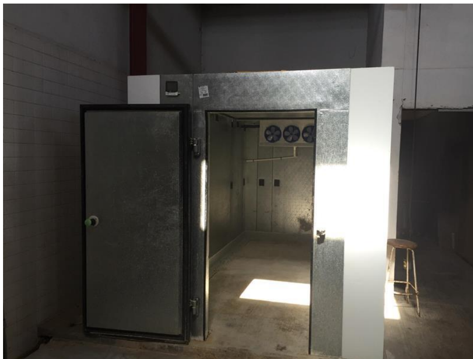
Imagen del nuevo cuarto frío del taller de carne.
