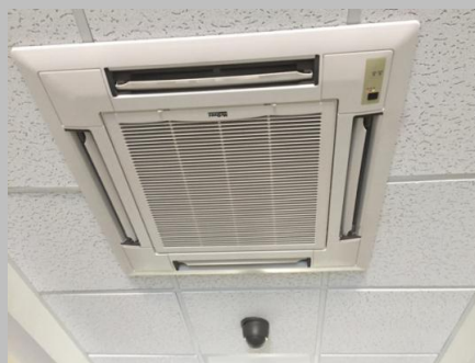
Figura 30. Sistema de clima controlado
