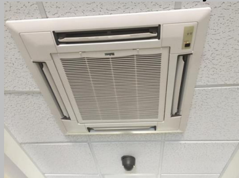
Figura 32. Sistema de clima controlado de bajo consumo de energía
