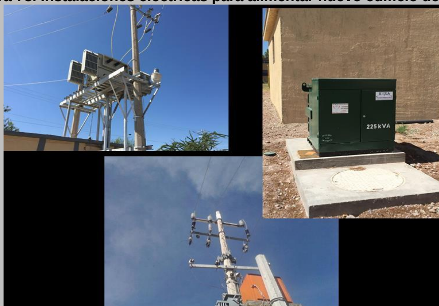
Figura 73. Instalaciones eléctricas para alimentar nuevo edificio de aulas
