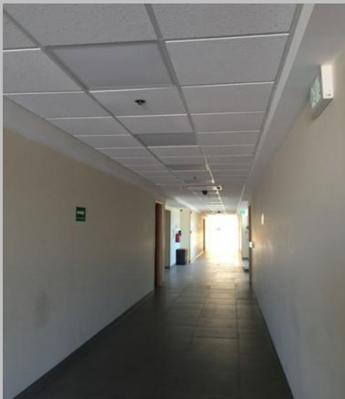
Figura 33. Imágenes de los aparatos de clima, sistema de iluminación LED en el edificio
