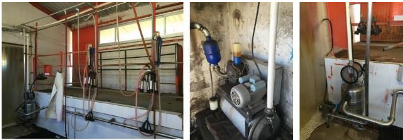
Imágenes del equipamiento de sala ordeña.
