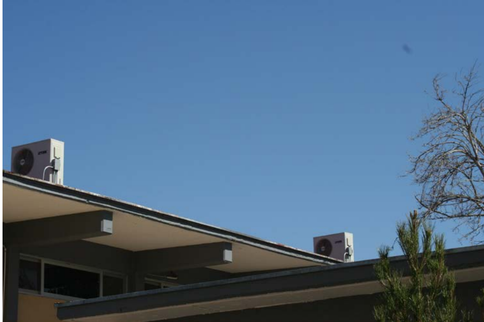
Vista exterior de los equipos de minisplit con que se equiparon el Edificio Delfino González.
