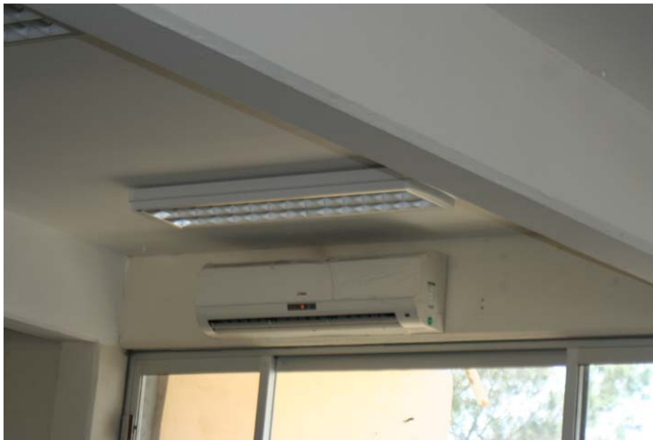
Cada uno de los salones del edificio Delfino González cuenta en forma individual con su propio minisplit.
