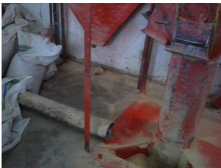
Tubo cruzado a nivel de suelo en el área de maniobra de la mezcladora
