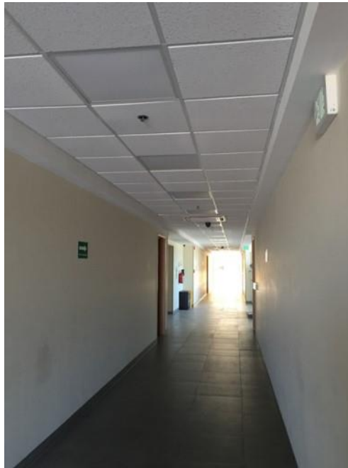
Imágenes de los aparatos de clima, sistema de iluminación LED en el edificio.
